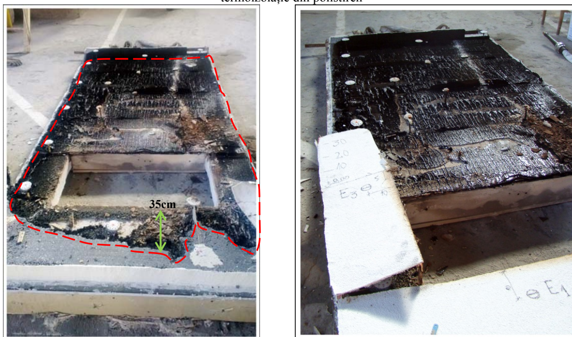
Fig. 7. Sistem compozit de izolate termică, după expunerea la acțiunea focului și decopertarea stratului de tencuială decorativă
